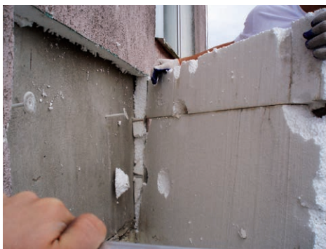
FOT. 4. Istniejące ocieplenie nieprzyklejone do podłoża; fol. archiwum autora
