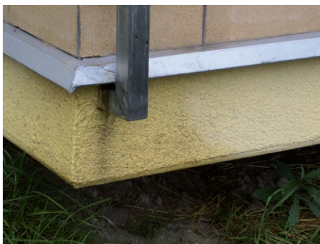
FOT. 19. Niewłaściwe zamocowanie bariery balkonu – zaciekanie wody; fot. archiwum autora
