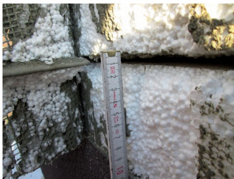
FOT. 16. Brak prawidłowego połączenia płyt styropianu, klej w spoinie; fot. archiwum autora
