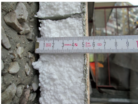
FOT. 7. Pomiar grubości ocieplenia podczas oceny odkrywkowej; fot. archiwum autora
