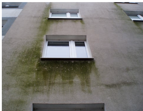
FOT. 23. Ocena stanu skażenia mikrobiologicznego na powierzchni tynków – miejscowo intensywne; fot. archiwum autora
