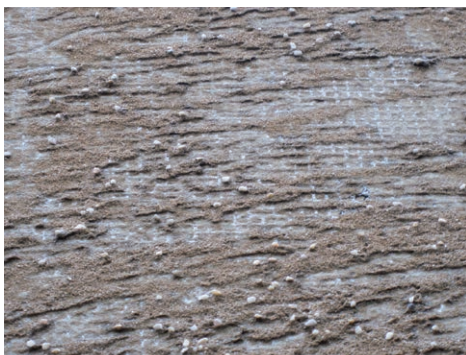
FOT. 17. Osypująca się warstwa tynku zewnętrznego; fot. archiwum autora
