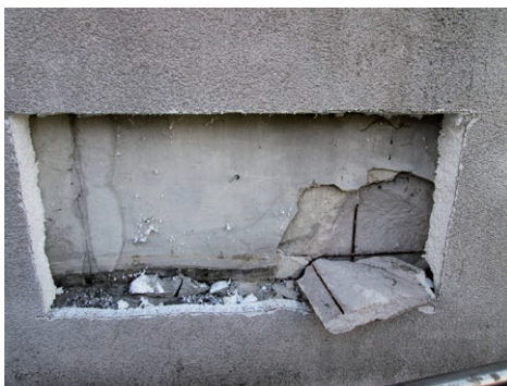
FOT. 15. Odkryte rozwarstwienie ściany nośnej – podłoże z gazobetonu; fot. archiwum autora
