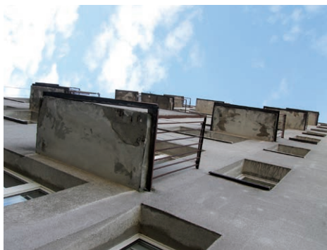
FOT. 20. Uszkodzone płyty balkonowe; fot. archiwum autora
