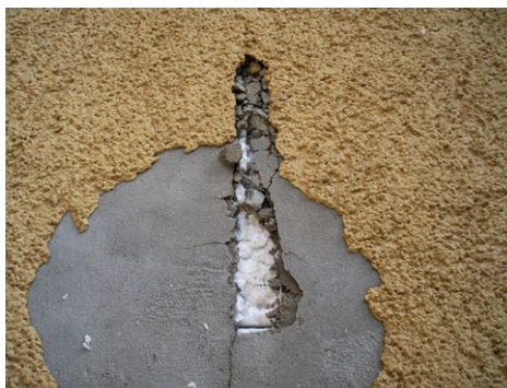
FOT. 18. Brak ciągłości zbrojenia (siatki z włókna szklanego) w warstwie kleju; fot. archiwum autora
