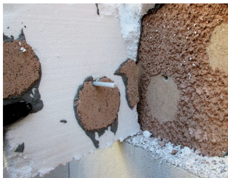
FOT. 6. Odspojenie ocieplenia z cząstkami podłoża i brak skuteczności mocowania mechanicznego (kołka); fot. archiwum autora
