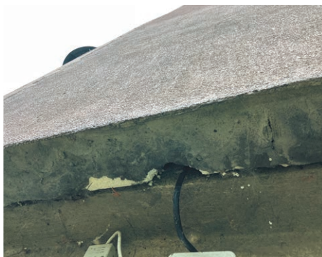
FOT. 4 Fragment elewacji południowej budynku położonego na południu Polski. Widoczny brak izolacji termicznej cokołu oraz niezastosowanie akcesoriów systemowych (profili startowych). Między izolatorem a podłożem występuje szczelina wentylacyjna, która uniemożliwia uzyskanie właściwych parametrów termoizolacyjnych przez system ociepleniowy; fot.: autor
