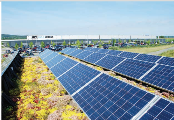
FOT. Fotowoltaika na zielonym dachu z roślinnością w uprawie ekstensywnej; fot.: Optigruen International AG
