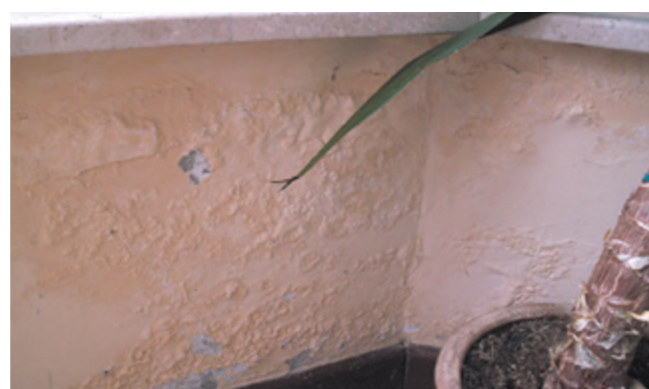
Skutki braku izolacji pionowej od strony wewnętrznej w budynku niepodpiwniczonym oraz przecieki na skutek błędów w obsadzeniu okien i parapetów
